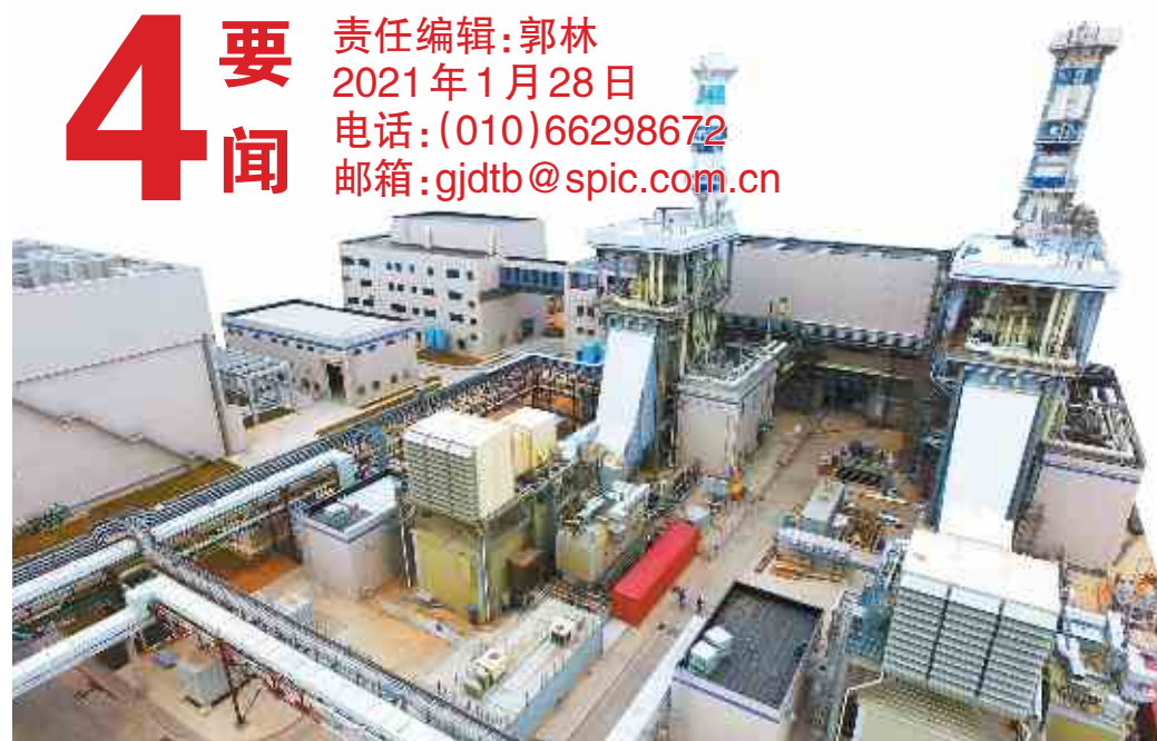
1月20日,中国电力江门综合天然气分布式能源站项目2号机组通过72+24小时满负荷试运行,实现双投,年供热量可达173万吉焦。马清华 摄
