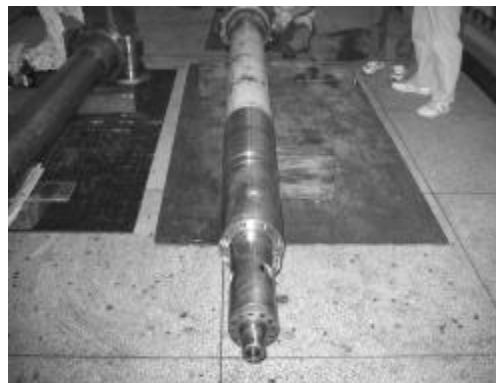
组装好后的受油器操作油管
