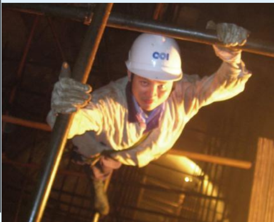
引水流道检查
