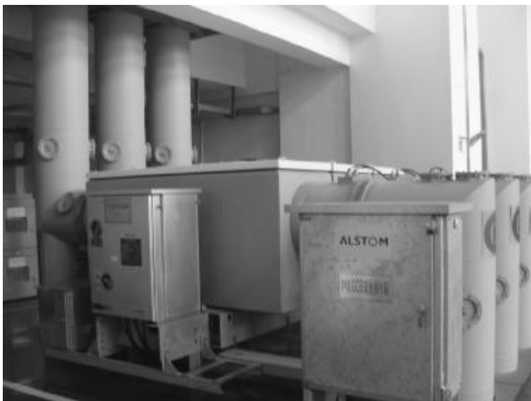
碗米坡电厂发电机 GCB
