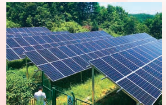
河南省商城县村级电站 ▲
